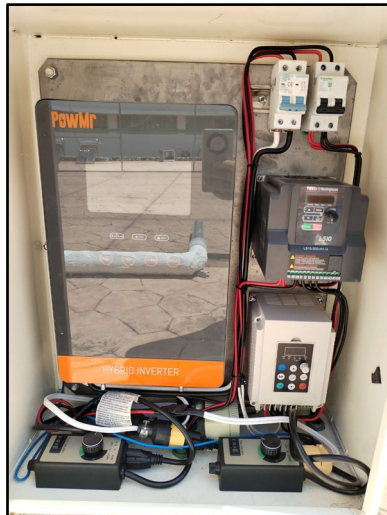
Figura 22. Tablero de control A.
