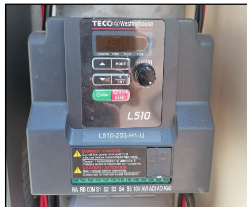
Figura 13. Variador de frecuencia para el ventilador.
