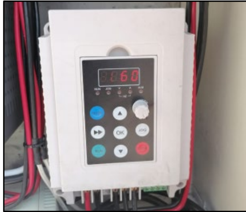
Figura 35. Encendido de la bomba de agua.
