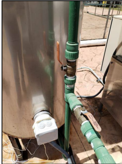
Figura 33. Posición de las válvulas del tanque de agua.
