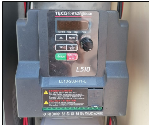
Figura 29. Encendido del ventilador industrial.
