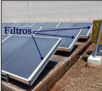
Figura 9. Filtros de aire.
