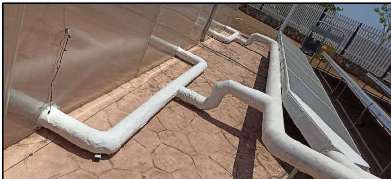
Figura 11. Línea de ductos de aire con aislante térmico.
