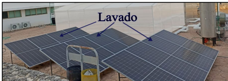
Figura 44. Lavado de paneles fotovoltaicos.
