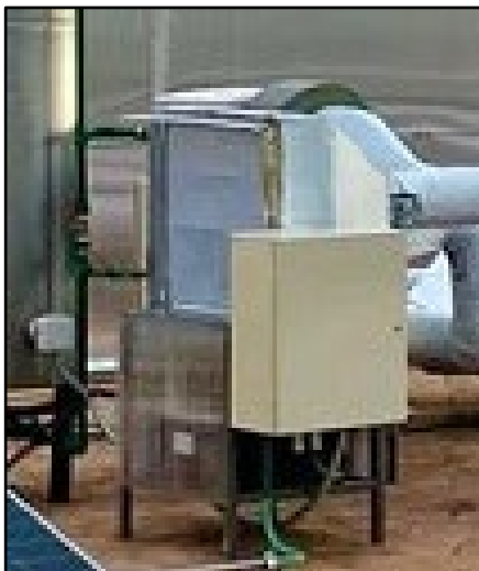
Figura 15. Intercambiador de calor.
