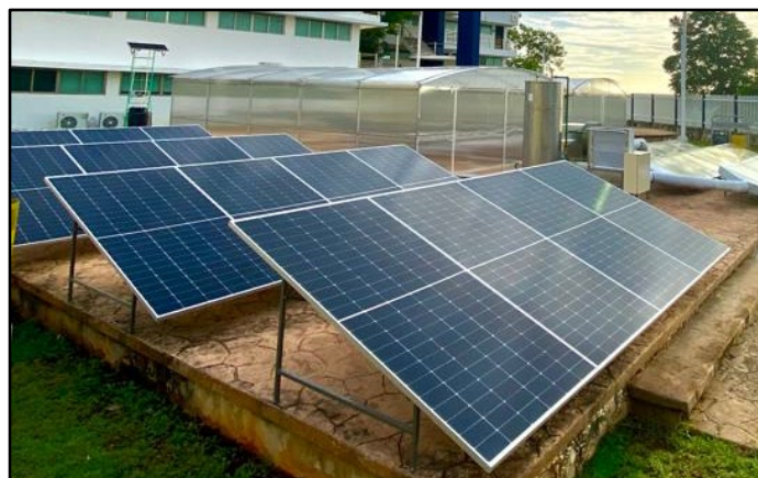
Figura 19. Arreglo de paneles fotovoltaicos.
