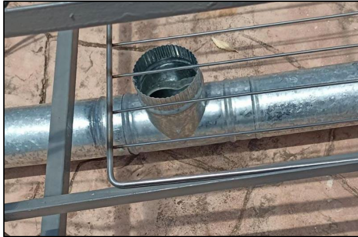
Figura 6. Terminal de ducto de aire caliente al interior de los invernaderos.
