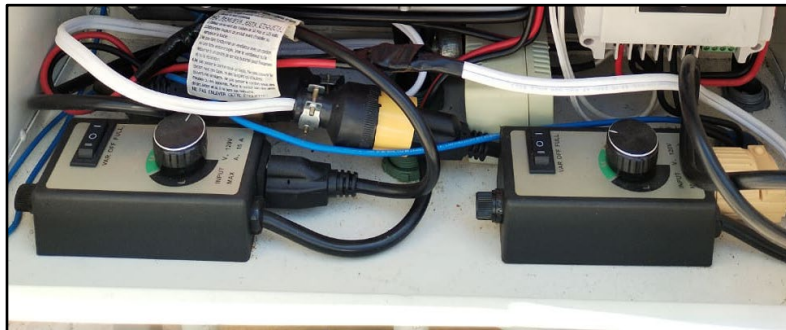
Figura 7. Variadores de frecuencia para los extractores.
