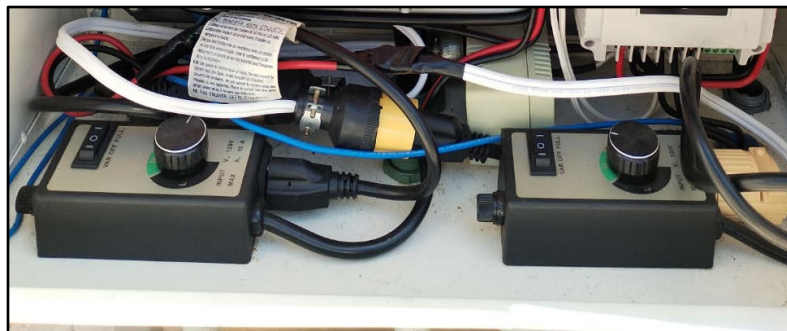
Figura 30. Encendido de los extractores de aire en los invernaderos.
