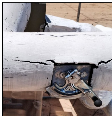
Figura 28. Válvula de acceso de aire desde los colectores solares abierta.
