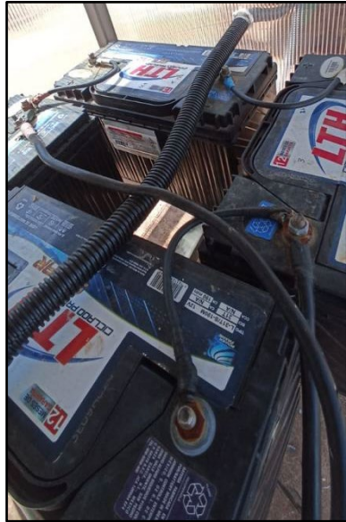
Figura 20. Banco de baterías.
