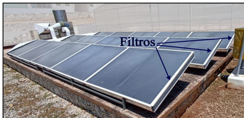
Figura 39. Ubicación de filtros de aire.
