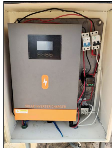
Figura 23. Tablero de control B.
