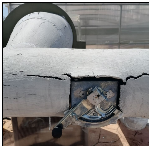
Figura 32. Válvula de acceso de aire desde los colectores solares cerrada.
