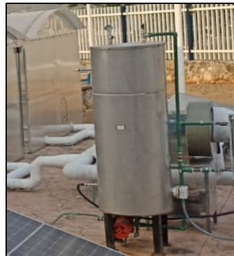
Figura 16. Tanque de almacenamiento de agua.
