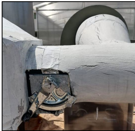
Figura 27. Válvula de acceso de aire desde el intercambiador de calor cerrada.
