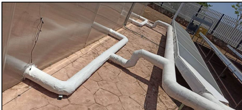
Figura 2. Ingreso de aire caliente por la parte trasera de los invernaderos.
